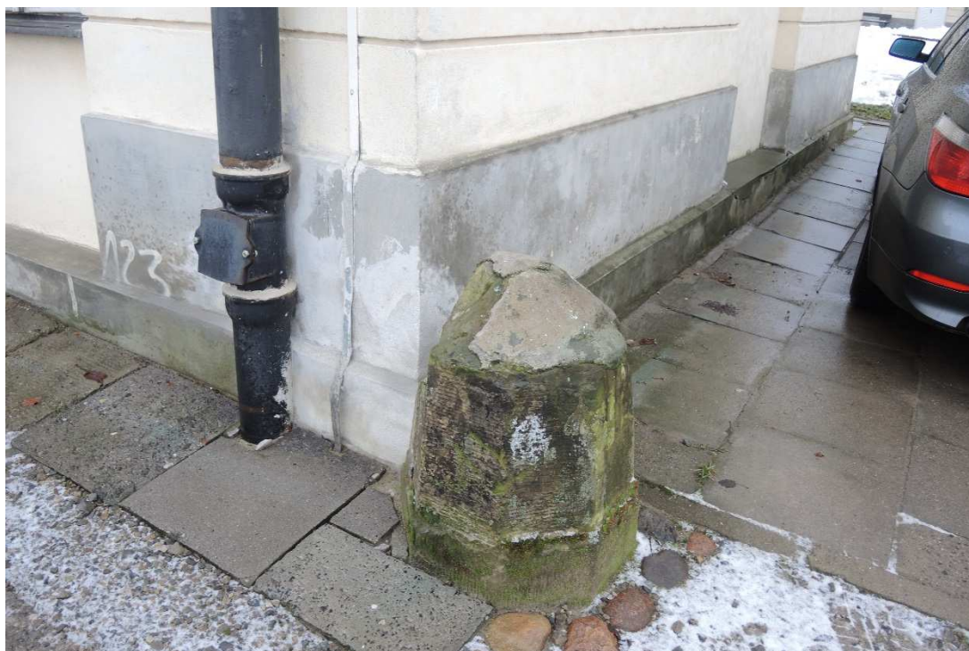
Fot. 7. Pachołek z piaskowca – stan korozji.
