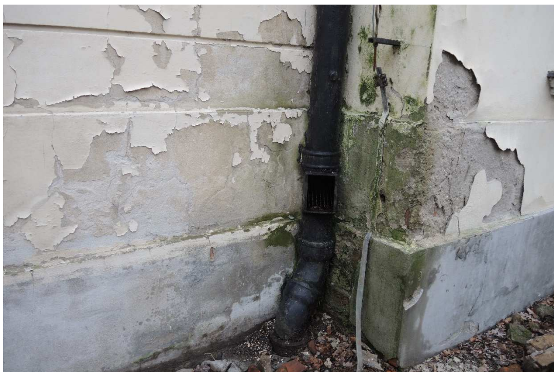
Fot. 8. Stan elewacji w miejscach zawilgoceń przy rurach spustowych (elewacja południowa).
