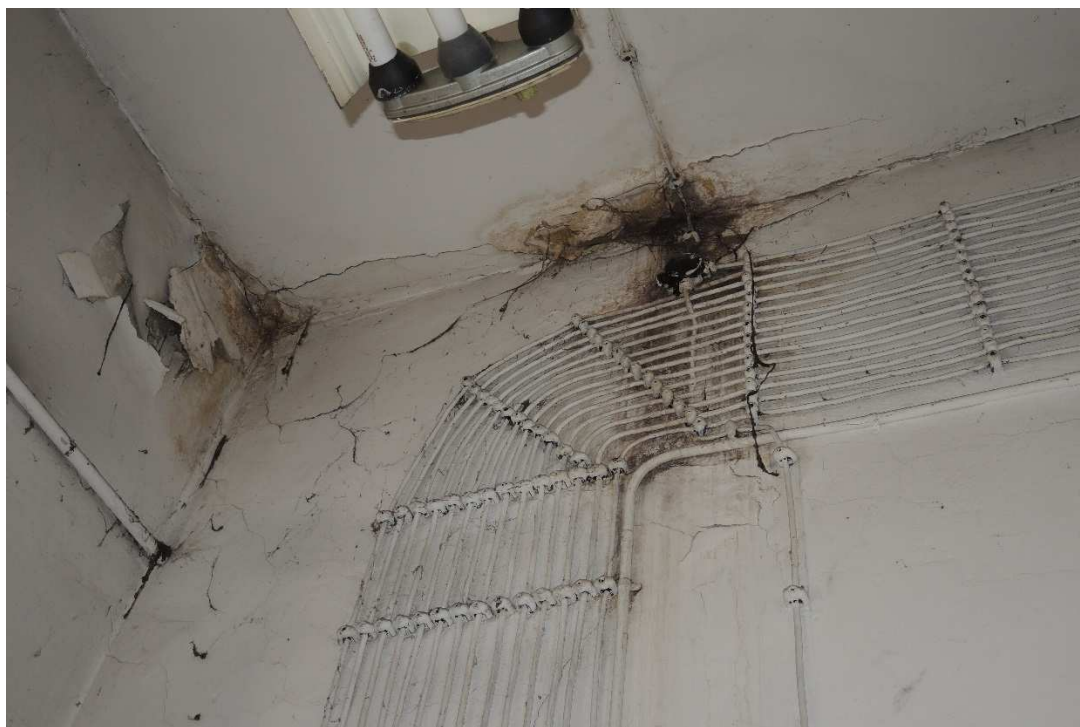
Fot. 13. Stan sufitu pod drewnianym stropem w d. wozowni wschodniej.
